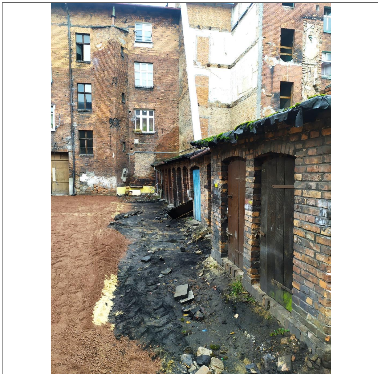
Fot. 3. Widoczne wychylenie budynku w kierunku zachodnim
