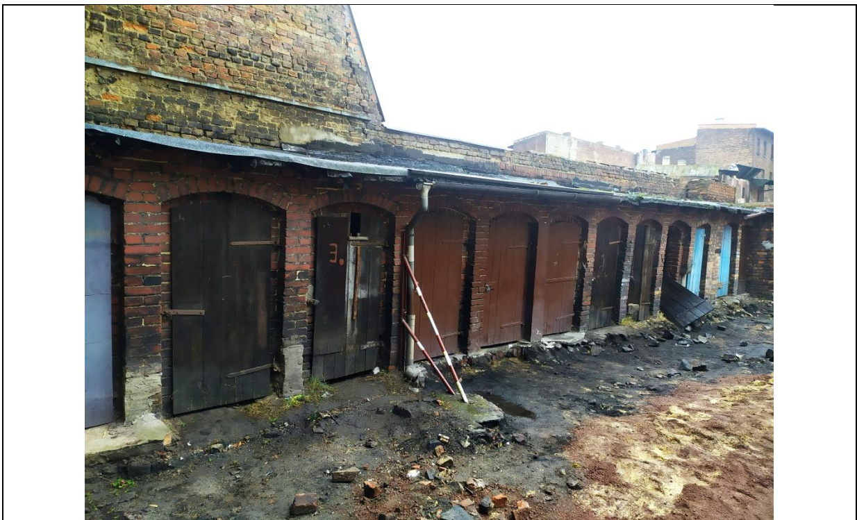
Fot. 2. Widoczna próba naprawy budynku.
